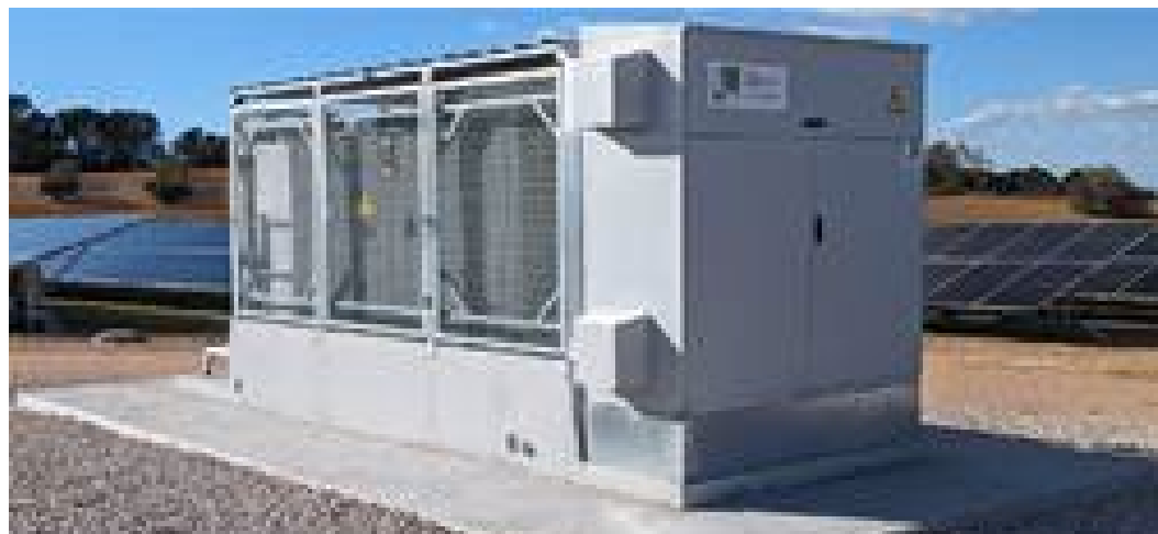
Figura 10. Exemple de Centre de Transformació 25/0,8 kV de 1,9 MVA de potència
